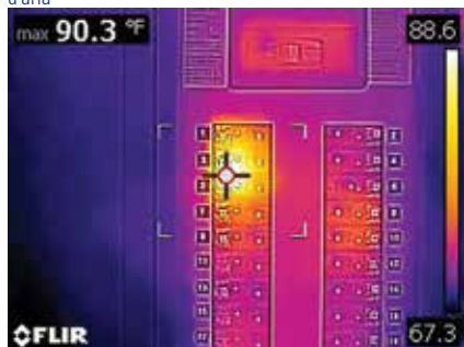
Riquadro con punto caldo che indica un fusibile elettrico attivo
